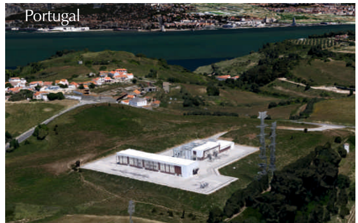
Trafaria Substation | REN – Rede Eléctrica Nacional Portugal | 2006/08
