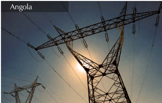
Linha de Alta Tensão, a 220 kV entre Dundo e Luena Empresa Nacional de Eletricidade – E.P. | Angola | 2013
